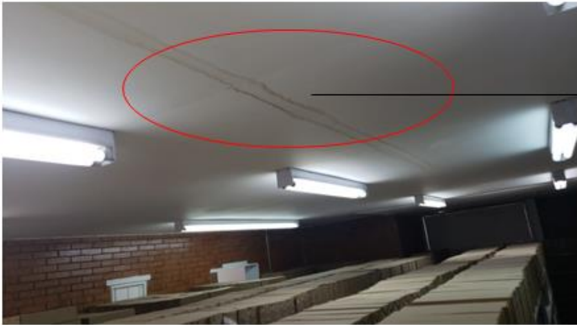
Filtraciones de Humedad.
