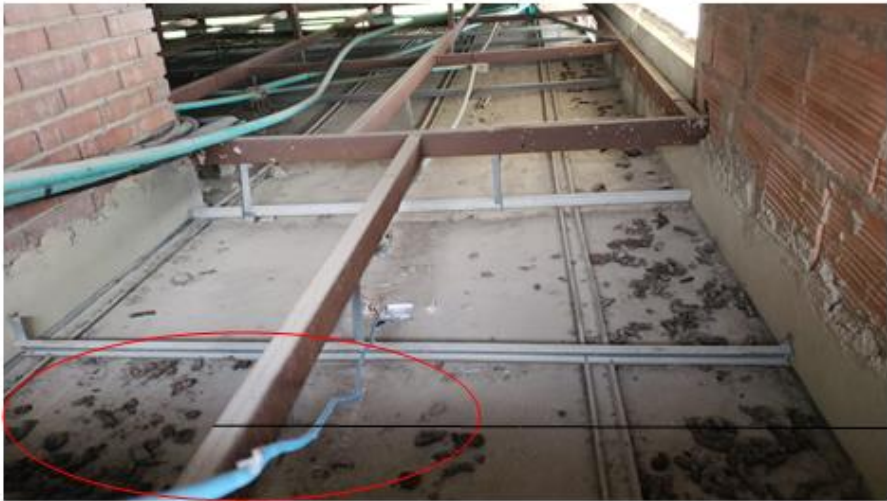
→ Heces de animales sobre las láminas de Drywall
