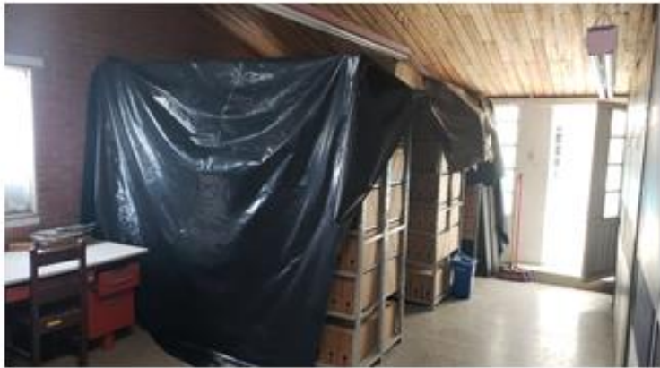
Se hace uso de plástico como única medida para la prevención del daño en el archivo durante futuras inundaciones.
