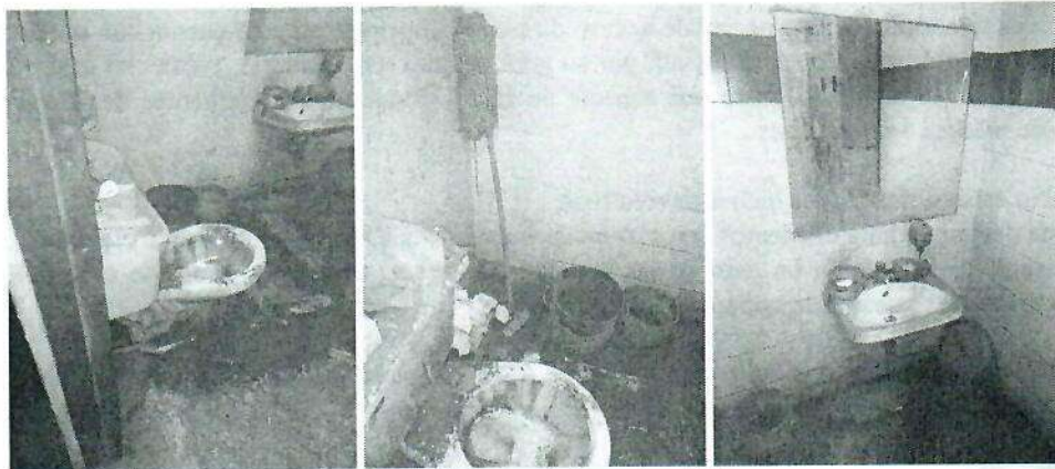
Baños en mal estado y condiciones insalubres
