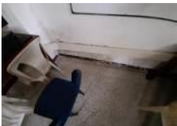
Imagen 45: sala de cómputo con humedad
