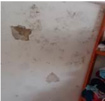
Imagen 43: Pared dormitorio humedad-estantes de ropa
