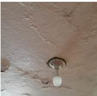
Imagen 42: humedad dormitorio techo
