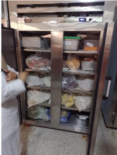
Imagen 12. Upi La Arcadia Refrigerador 1
