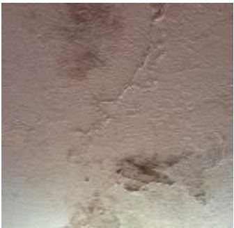
Imagen 41: humedad dormitorio techo
