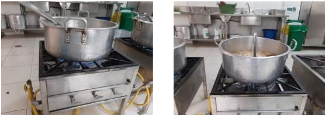
Imagen 50 y 51. Estufas industriales con escape de gas.
