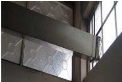
Imagen 96. Chimenea o ducto de salida de gases de Horno de panadería. UPI Perdomo
