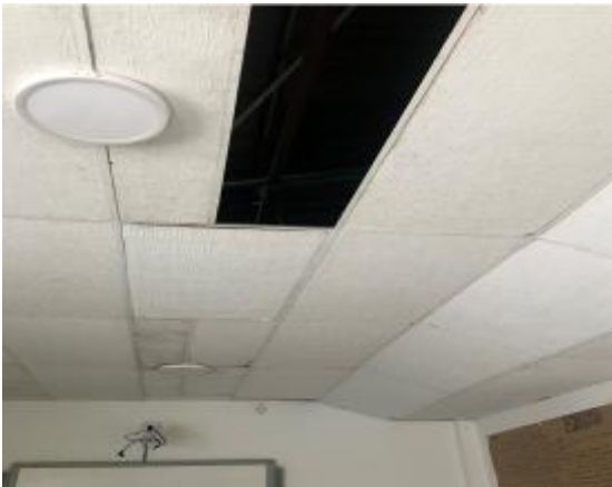
Imagen 116 y 117. Techos salones dañados
