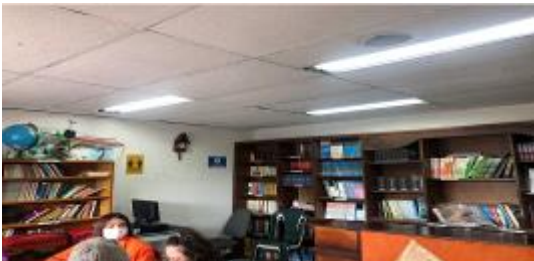
Imagen 115. Techo dañado de la biblioteca
