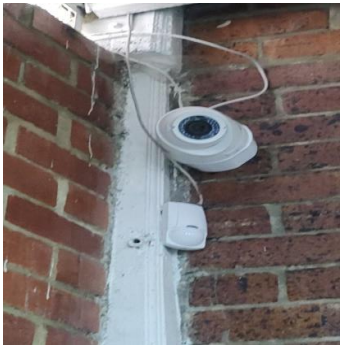
Imagen No. 49. Upi La Florida Bodega 1 de seguridad Cámara de video inservible
