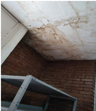
Imagen No. 48. Upi La Florida Bodega 2 evidencia de filtraciones de agua
